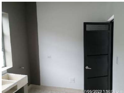
Ilustración 16. Chapas de puertas por rectificar.
