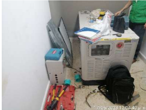
Ilustración 18. Planta y cuarto eléctrico sin concluir.
