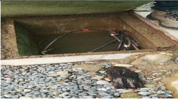
Ilustración 3. Caja RS3-002 Inundada.
