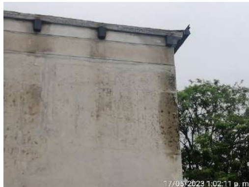
Ilustración 14. Canoa por encima de losa de cubierta.
