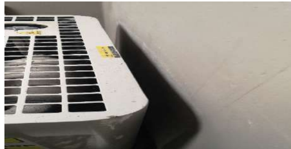
Ilustración 8. Planta eléctrica contra pared.
