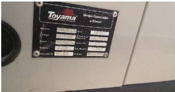
Ilustración 1. Placa planta eléctrica.
