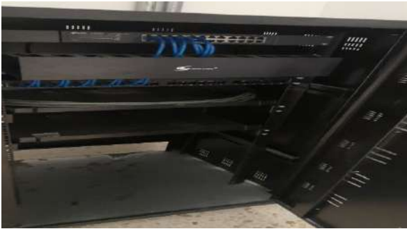
Ilustración 5. El Rack no está funcionando.
