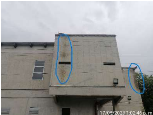
Ilustración 13. Canoas con problemas de instalación.
