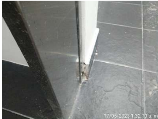
Ilustración 12. Pendiente remate de zócalo en baño.
