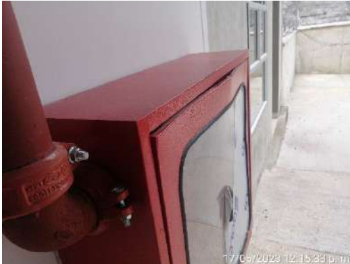
Ilustración 17. Gabinete red básica de incendios.
