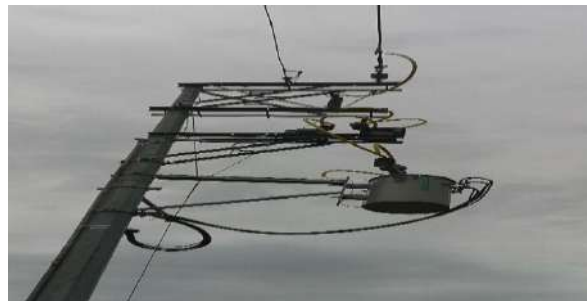
Ilustración 2. Transformador y equipo de medición a 7.6 kV
