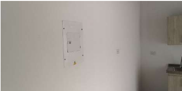
Ilustración 7. Falta marcación en tablero.
