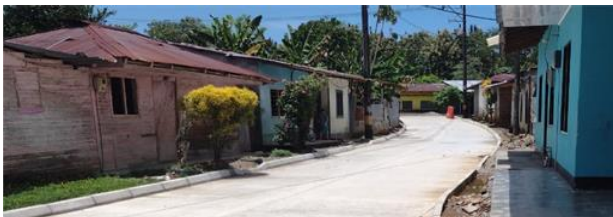
Pavimentación vía Urbana. Bajo Cauca, Municipio de Cáceres. Secretaría de Infraestructura Física.
