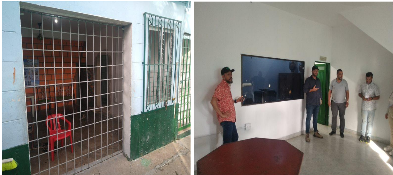
Visita adecuación Cárcel de Tarazá Subregión Bajo Cauca, municipio Tarazá Equipo de Infraestructura – Secretaría de Seguridad y Justicia
