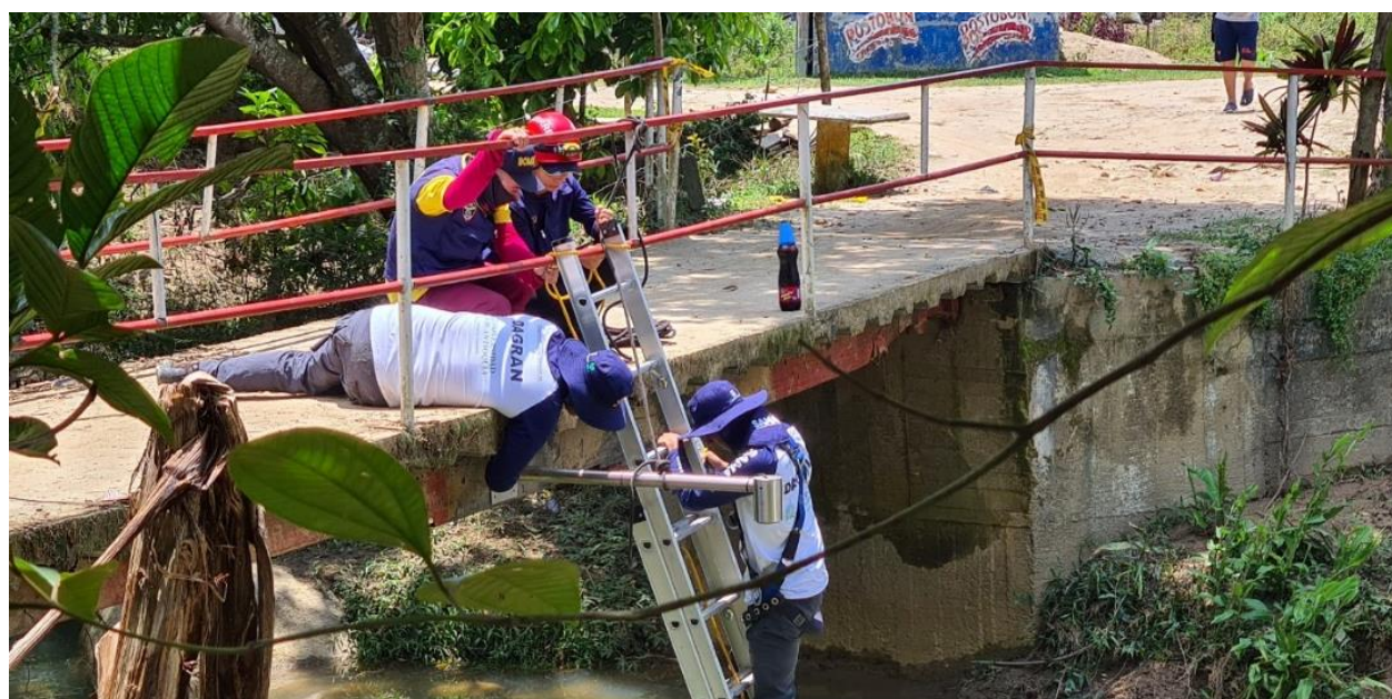
Instalación Sensor de Nivel – Sistema de Alerta y Monitoreo de Antioquia Oriente, municipio San Carlos. DAGRAN
