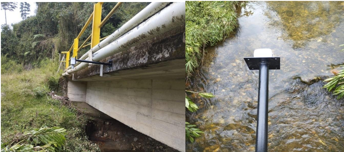
Primer piloto de sensores para monitoreo de aumento en el nivel de los ríos en línea a través de la implementación de una red Lora del tipo LPWAN
